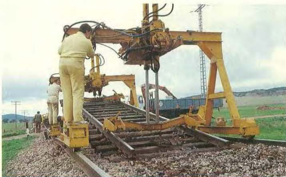
1 Los pórticos, sobre carriles auxiliares, proceden al levantamiento de los tramos de vía.
